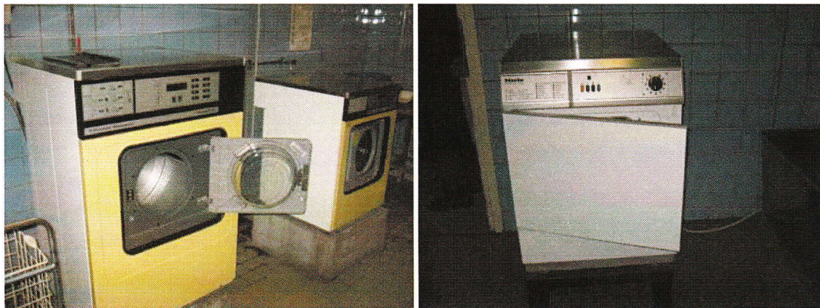
Tvättstugan i fastigheten.
