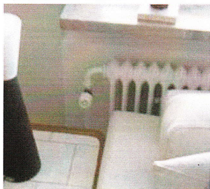
Vattenradiator med termostatstyrning.
